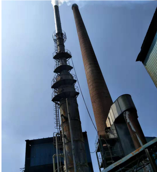
湿式脱硫除尘装置
